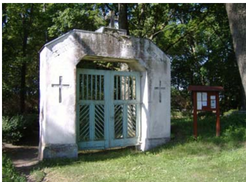
21.attēls. Mušķu kapu ieejas vartu pirms remonta
